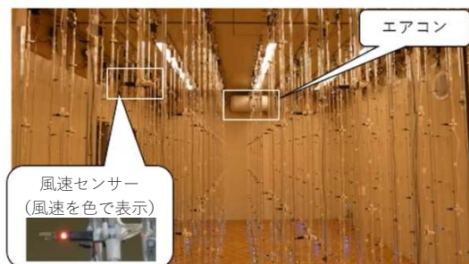
AE Lab にセンサーを設置した様子
