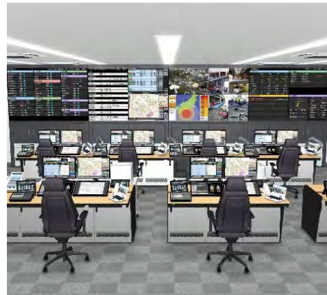
消防システム
